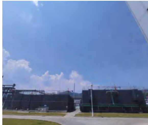
综合废水处理设施
