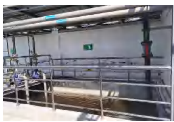
综合废水排放口
