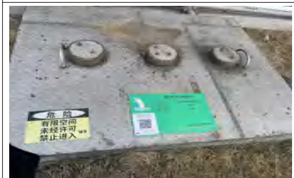
含镍废水车间排放口
