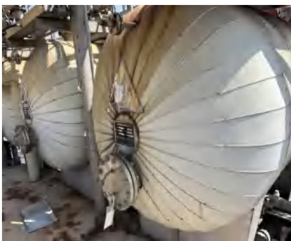
含卤废气处理设施
