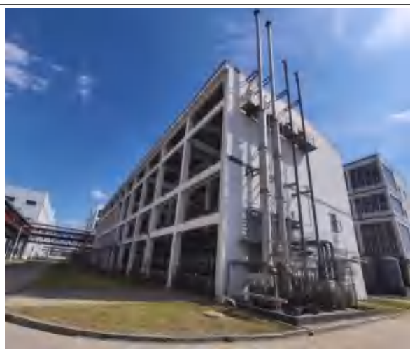
9车间含氢废气处理设施
