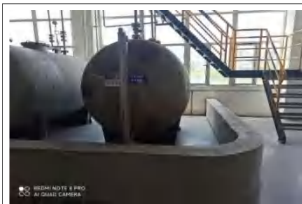
车间高浓废水罐
