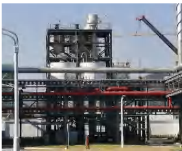
MVR 脱盐设施
