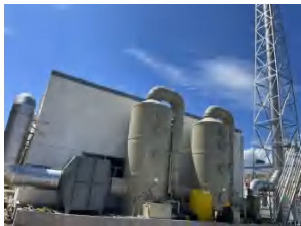
危废堆场废气处理设施
