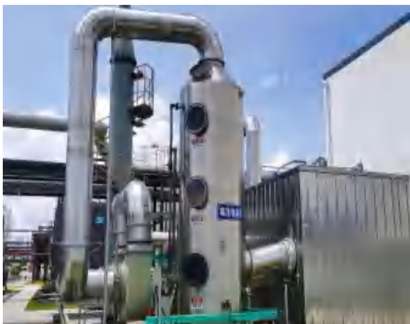
生物滴滤废气处理设施
